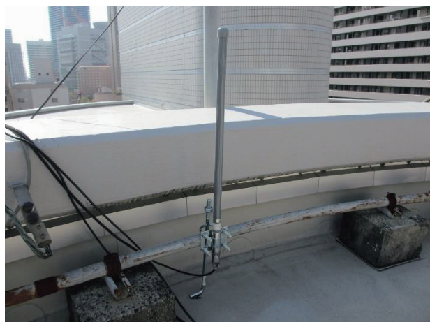
図2 屋上に設置した 1090MHz アンテナ
